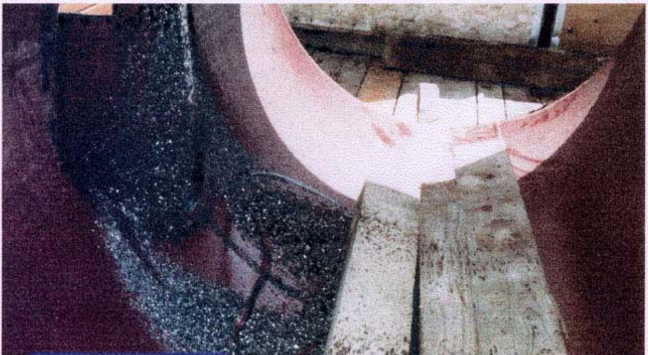
Foto 1: Prueba de Hot-Tapping de diámetro grande realizada en un tubo de una línea de diámetro grande. Note la cantidad de rebabas de metal y cortes que se introducen en el ducto. Se sospecha que esta sea una de las causas principales que dañan los sellos del asiento que dan como resultado fugas en los asientos de las válvulas.
